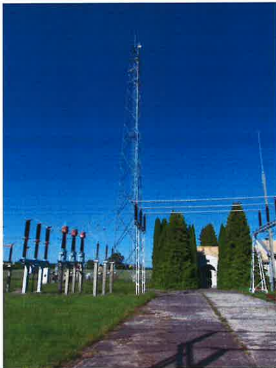
Zał. nr 1: Widok ogólny instalacji radiokomunikacyjnej.
