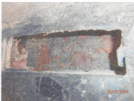
Skorodowane pole numerowe
