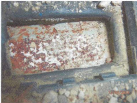
Skorodowane pole numerowe
