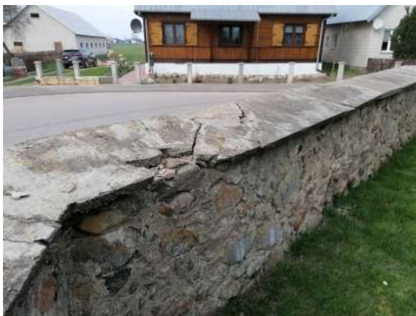
Fot. nr 10- Ubytki warstwy wierzchniej w murze- od strony płn.- zach.
