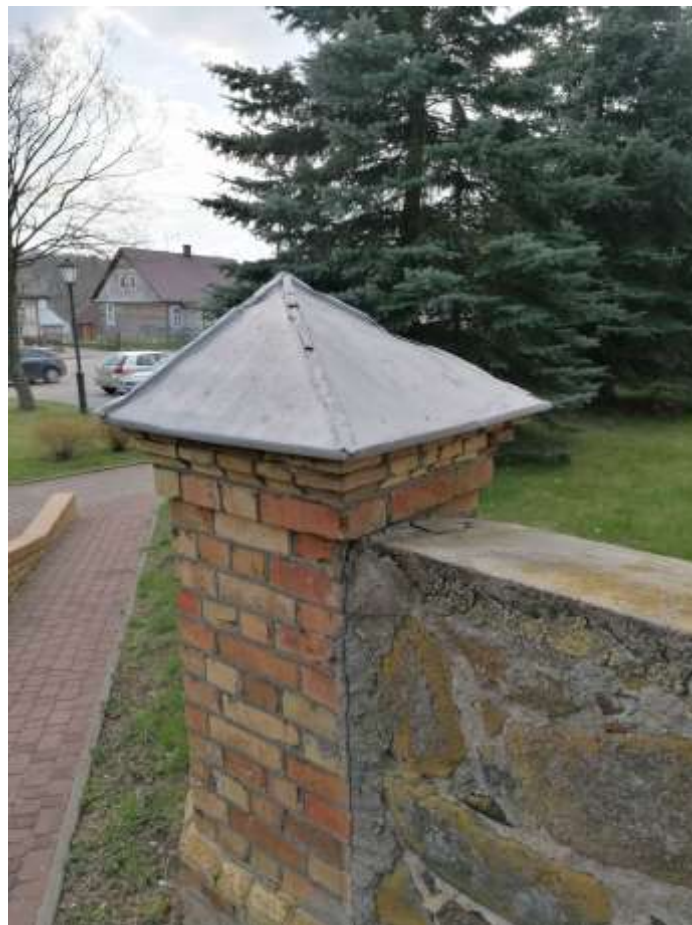
Fot. 10- Uszkodzone obróbki blacharskie (płd- wsch).
