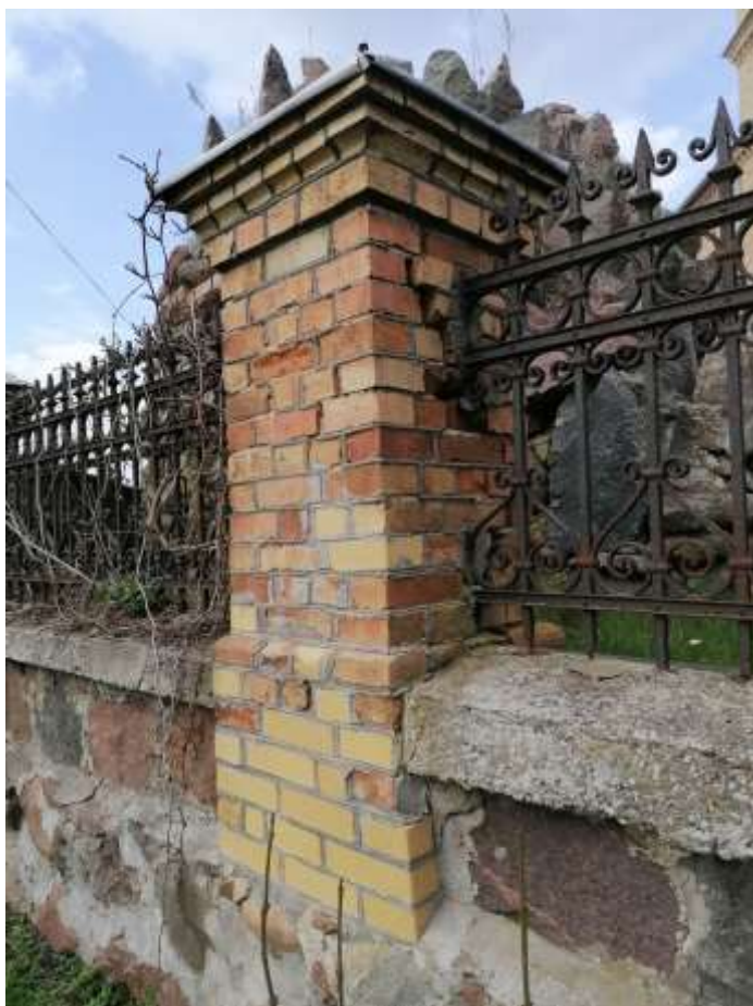
Fot. nr 9- Ubytki w murze (płd- zachd)
